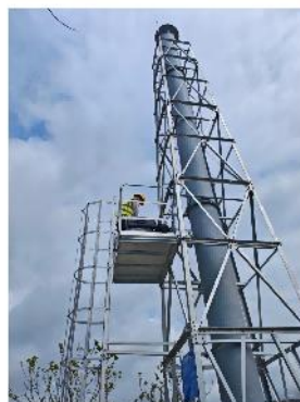
1#生物滤池排气筒废气采样口 (DA001)
