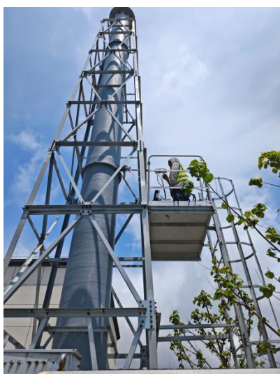
2#生物滤池排气筒废气采样口 (DA002)
