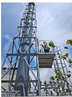
2#生物滤池排气筒废气采样口 (DA002)
